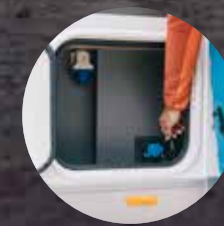
CENTRALE TECHNIQUE EXTÉRIEURE
